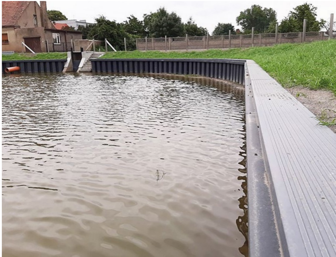
OKOLICE POZNANIA, POLSKA: REWITALIZACJA ZBIORNIKA RETENCYJNEGO - STABILIZACJA BRZEGÓW ZA POMOCĄ OPASKI Z GRODZIC WINYLOWYCH WYKOŃCZONEJ OCZEPEM I MODERNIZACJA UPUSTU WODY POPRZECZ MONTAŻ ZASTAWKI RETENCYJNEJ W ISTNIEJĄCYM JAZIE.
