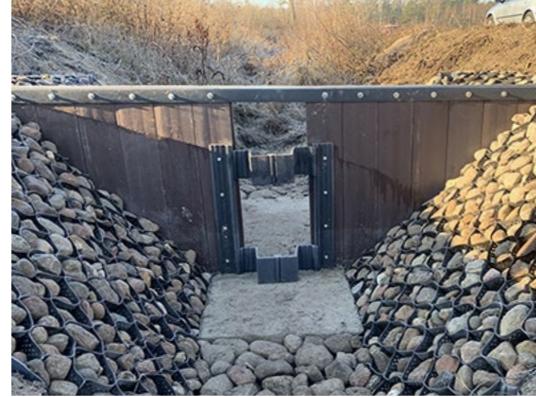
GRABÓW, POLSKA: DRUGI RODZAJ ZASTAWEK RETENCYJNYCH, ZAINSTALOWANY NA TYM SAMYM OBSZARZE MELIORACYJNYM W DORZECZU PILICY.
